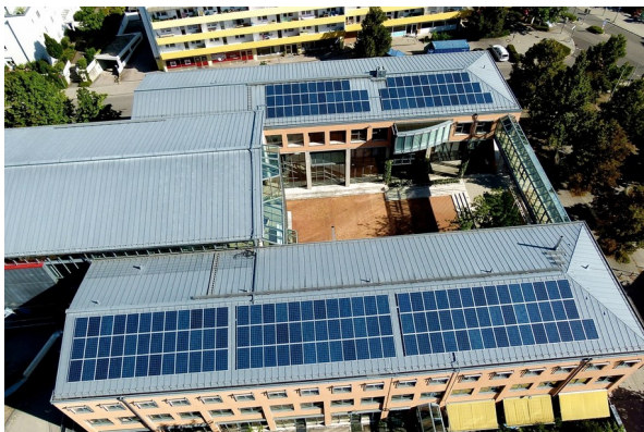
Photovoltaik-Anlage auf dem KUBIZ
